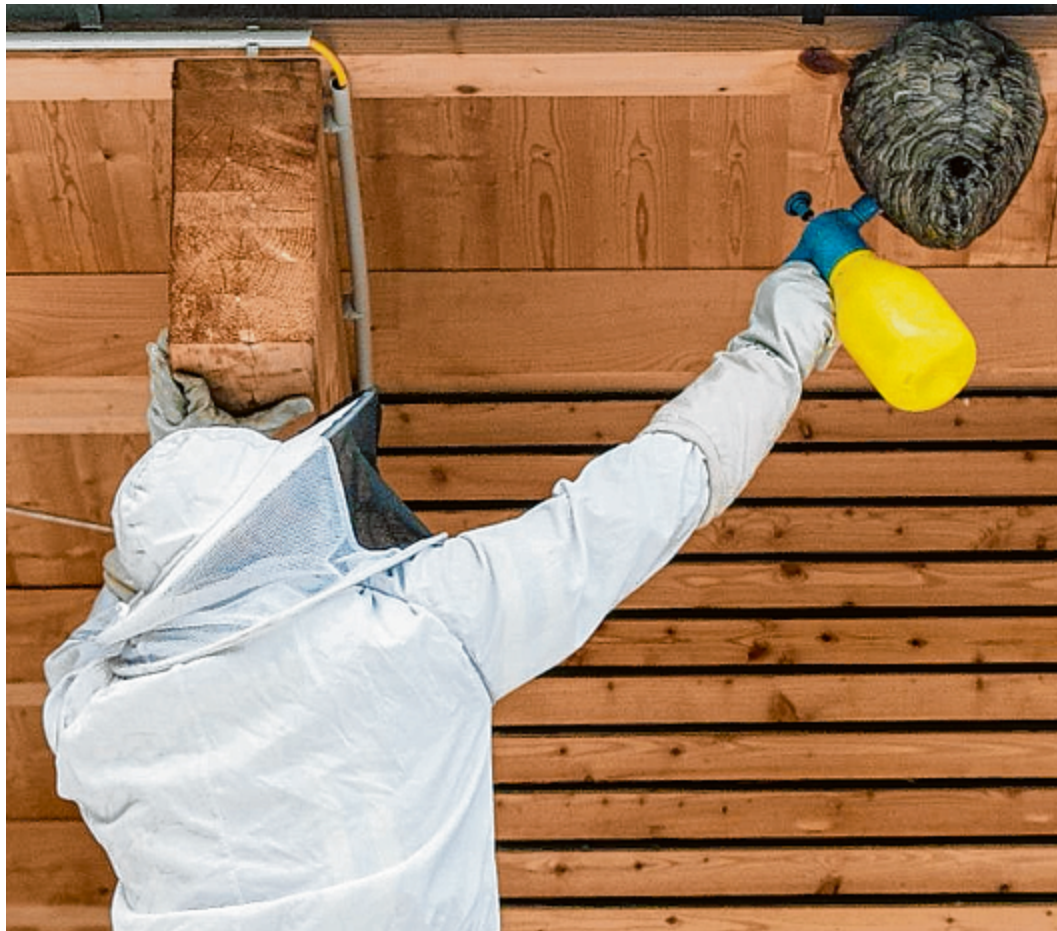
Die Entfernung eines Wespennestes in dieser Größe sollte unbedingt Profis überlassen werden.
